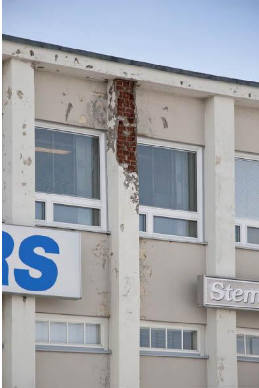
Paikka paikoin julkisvuissa on vaurioita, kuten kuvassa itäisen julkisivun rapatussa tiilipilasterissa. Kuva Pekka Piiparinen
