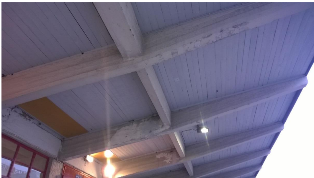
kuva 12, katoksen alapinnan betonipalkeissa ja puuverhouksessa on pintavaurioita
