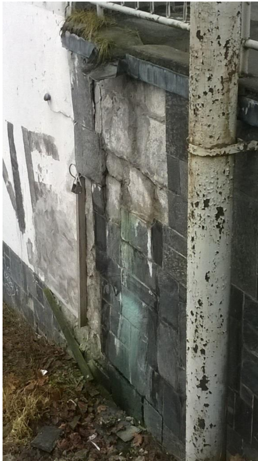
kuva 9, vuotava syöksytorvi vaurioittaa perusmuuria
