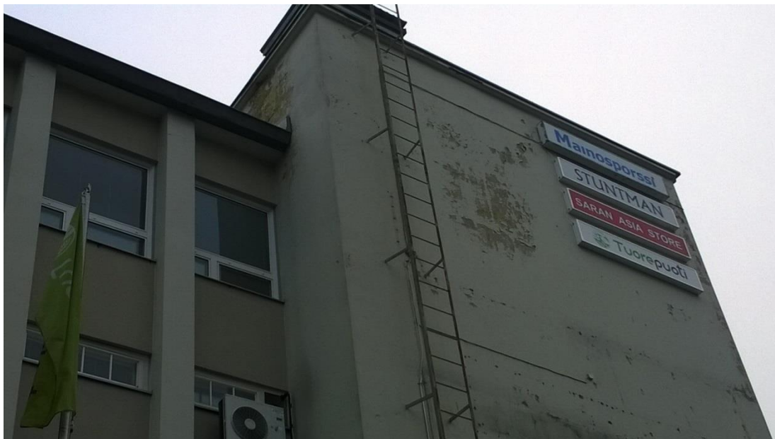
kuva 3, tikas ei täytä turvamääräyksiä, julkisivussa maalivaurioita
