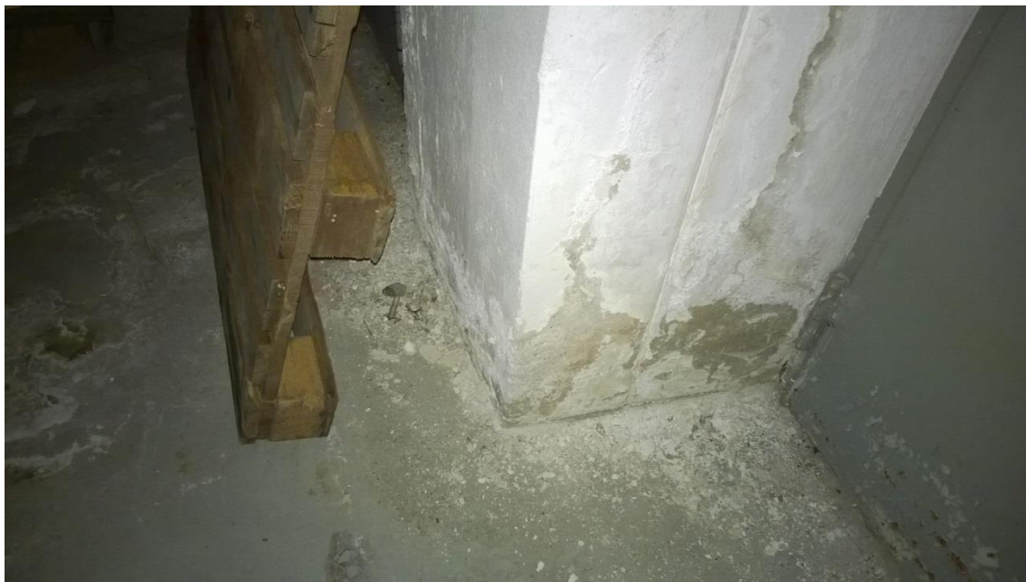
kuva 22, pilarin alapään vesivaurioita kellarissa
