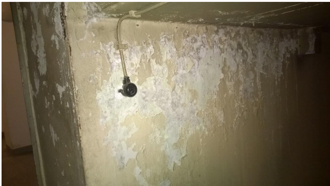
kuva 16, kellarin seinän vesivaurioita; alkuperäisiä sähköasennuksia
