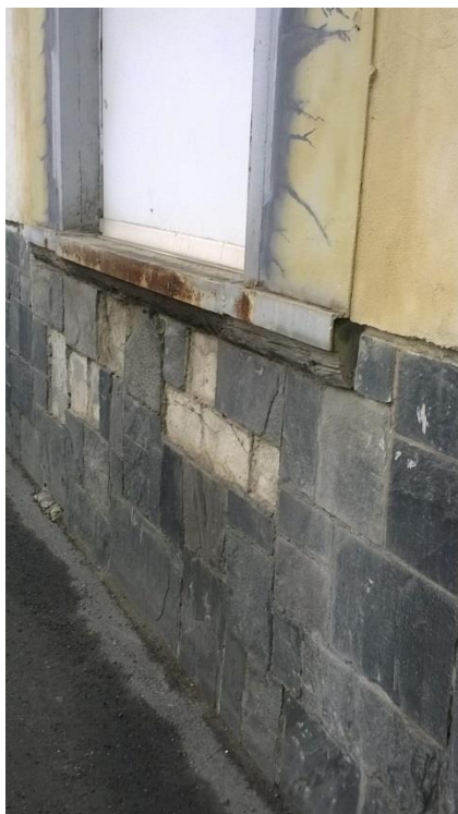
kuva 8, liuskekivet ovat irronneet perusmuurin pinnasta
