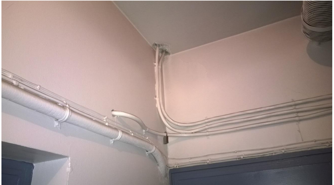
kuva 24, läpivientejä ei ole tiivistetty palokatkomassalla
