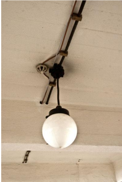
Varastotiloissa on vielä jäljellä 1950-luvun valaisimia. Kuva Pekka Piiparinen
