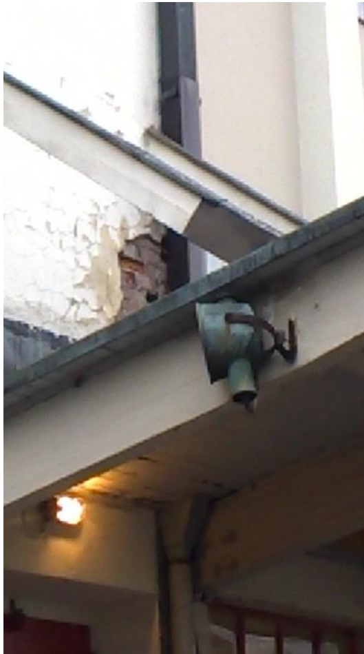
kuva 11, katoksen vedenpoistojärjestelmä vuotaa
