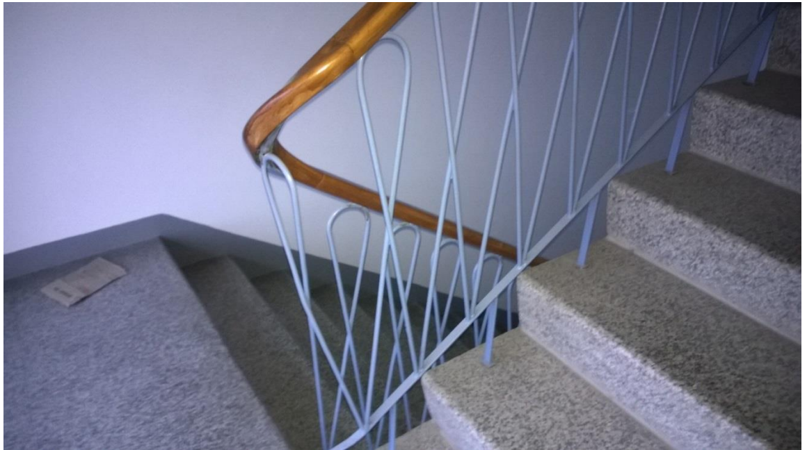
kuva 23, eteläpään portaan pinnoitus on kunnossa, kaide ei täytä nykyisiä turvallisuusmääräyksiä
