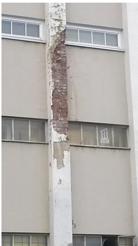
kuva 4, vuotava vesi on rapauttanut julkisivun
