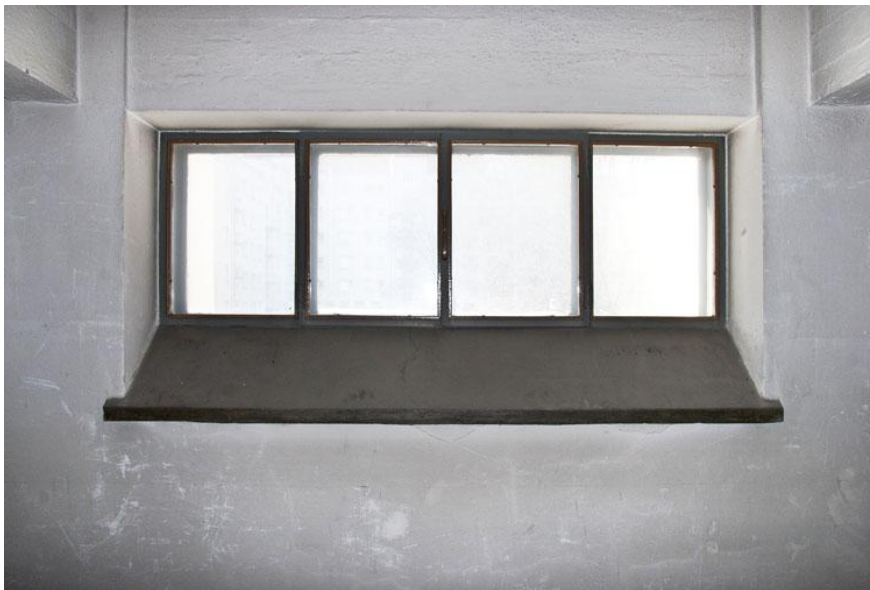
Edelleen varastokäytössä olevien huoneiden ikkunoiden karmit ovat alkuperäistä materiaalia eli rautaa. Kuva Pekka Piiparinen
