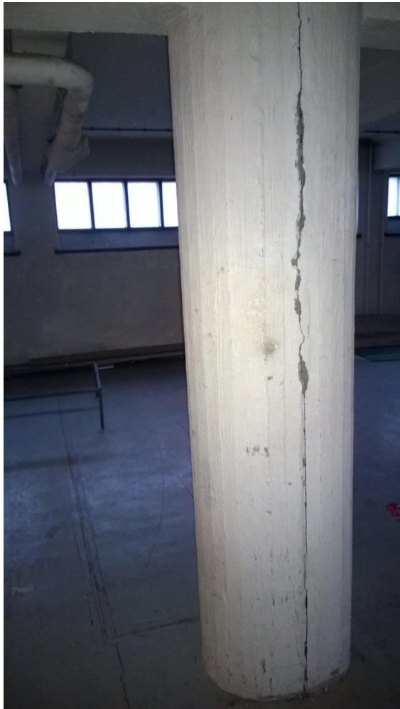
kuva 26, pilarin liikuntasäily toimituskerroksessa
