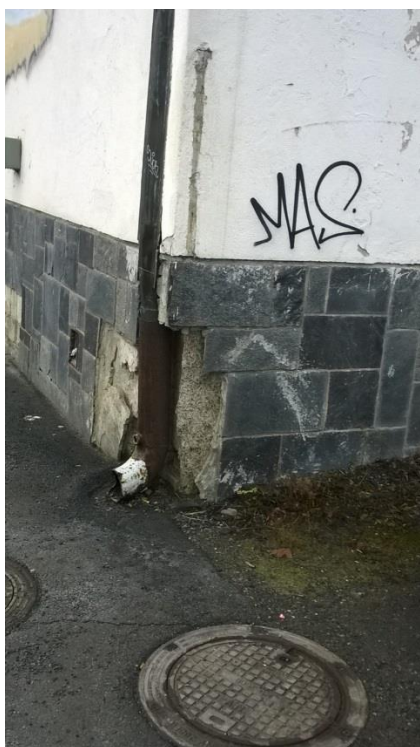
kuva 7, syöksytorvesta vuotanut vesi on aiheuttanut perusmuurin rapautumisen
