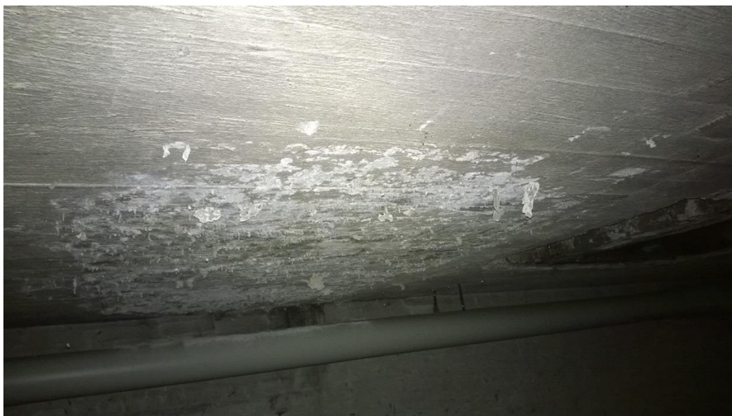
kuva 18, kellarin katon vesivaurioita
