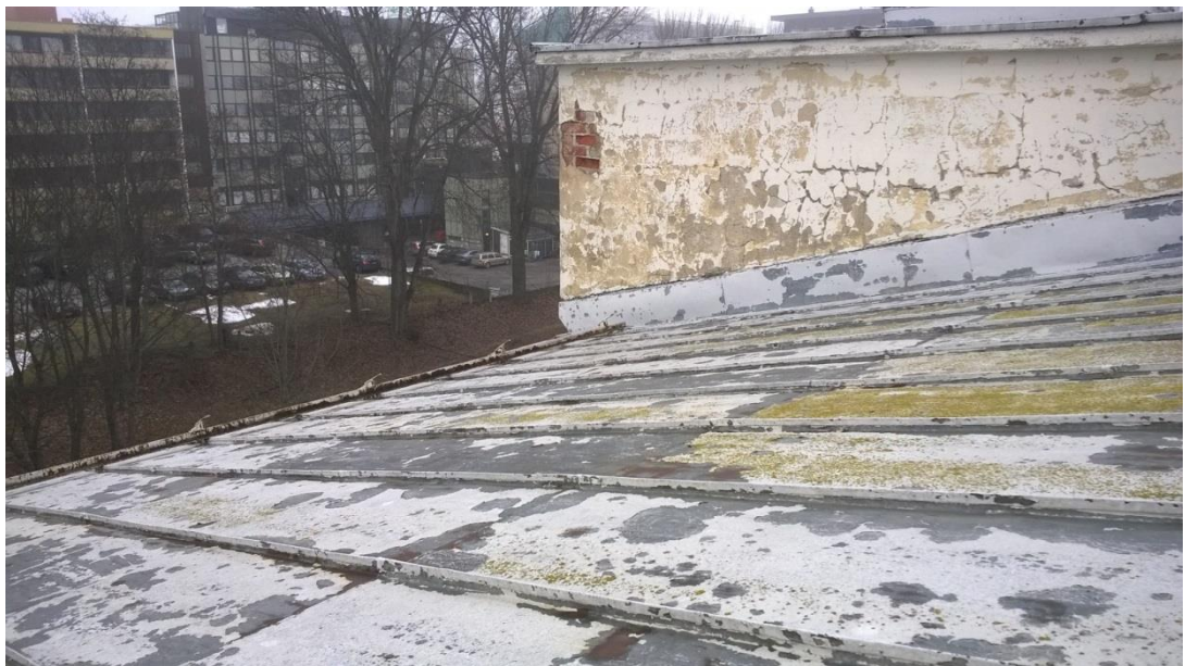
kuva 14, vesikaton pinnoitus kaippaa uusintaa
