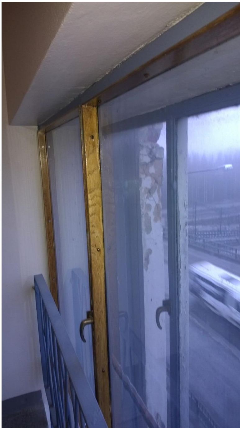
kuva 25, eteläpäädyn porrashuoneen ikkuna on alkuperäinen; ikkunan pielessä vesivaurioita
