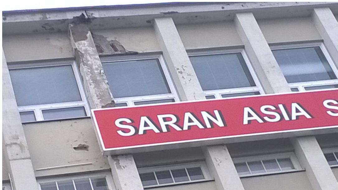
kuva 5, vesikouru ja syöksytorvi vuotavat
