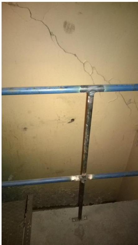
kuva 17, kellarin seinissä on paljon halkeamia
