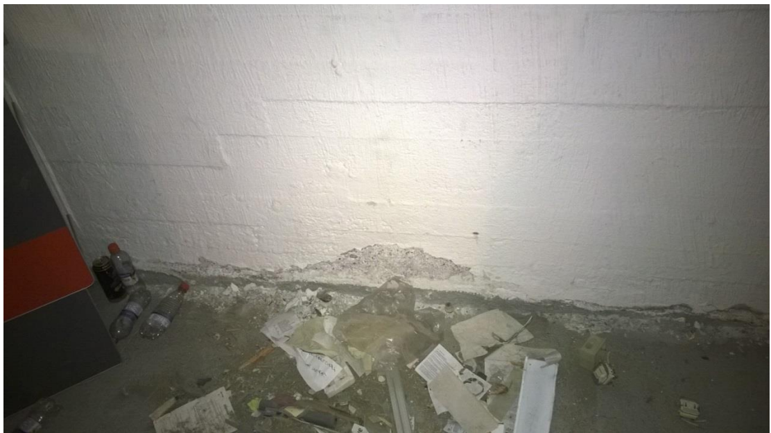
kuva 20, kellarin seinän alaosan vesivaurioita
