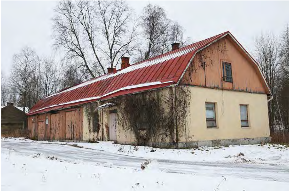
Rakennuksen huono kunto on heikentänyt rakennuksen arvoja.
