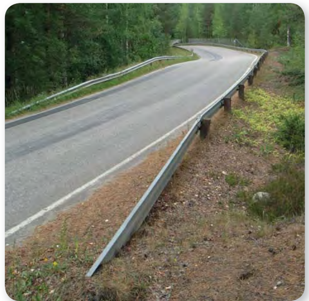
Kuva 52. Porrassalmentie pohjoispäässä on suunnitteluohjeiden mukainen teräksinen kaide.
