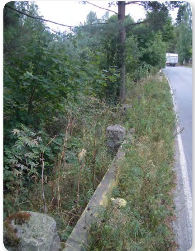
Kuva 63. Kunnostettavaa kaidetta Annilan kohdalla
