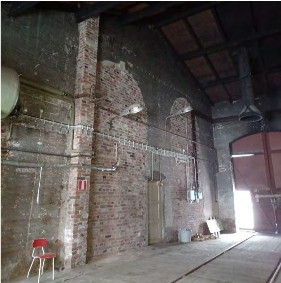
Kuva 76. Seinissä näkyy alkuperäinen aukotus. Alun perin tiiliseinät ovat olleet kalkatut. Maalipinta on noesta tummunut.
