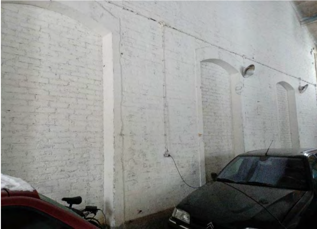
Kuva 106. Umpeen muurattuja oviaukkoja. Seinän takana on tila 3–4 eli petankkihalli. Seinällä näkyvät pyöreät valaisimet ovat alkuperäiset ja toimivat edelleen.
