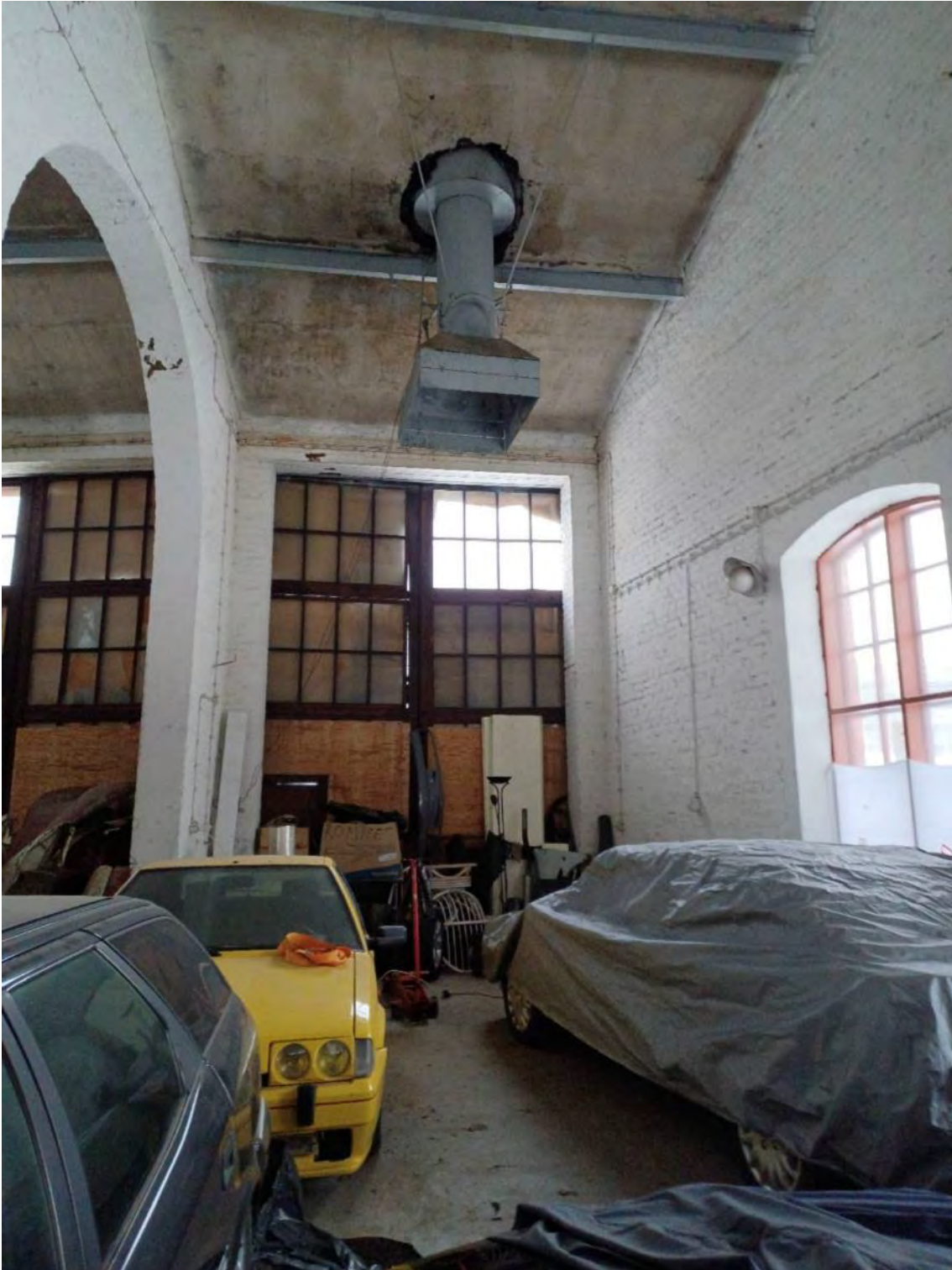
Kuva 105. Tilassa on betonilattia ja tiiliseinät. Puisten, alkuperäisen mallin mukaisten tallinovien (1 ja 2) suuret, moniruutuiset ikkunat on peitetty vanerilla ilkeivällä vuoksi. Ikkunoiden sisäpuitteet vaihdettu 1-ruutuisiksi. Pyöreät valaisimet todennäköisesti alkuperäiset, ja toimivat edelleen.
