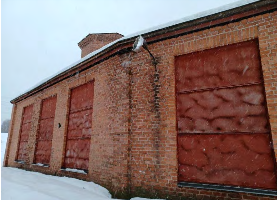
Kuva 43. Laajennusosan ikkunat on peitetty ilkkivallan vuoksi.
