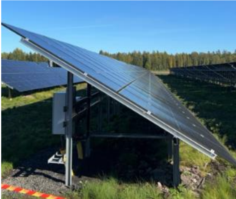
Kuva 8. Omien perustusten varaan asennettuja aurinkopaneeleita (Sitema Oy)
