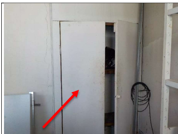
ASB.04, RAK.18, repijälaitteisto, rakennuslevy
