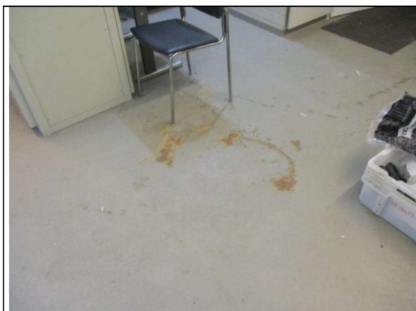
PCB.02, RM.06, Valvomo, 1. kerros, lattiamaali
