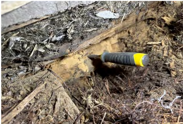
Kuva 20. Lahovaurioituneita ulkoseinän alaosan hirssiä.
