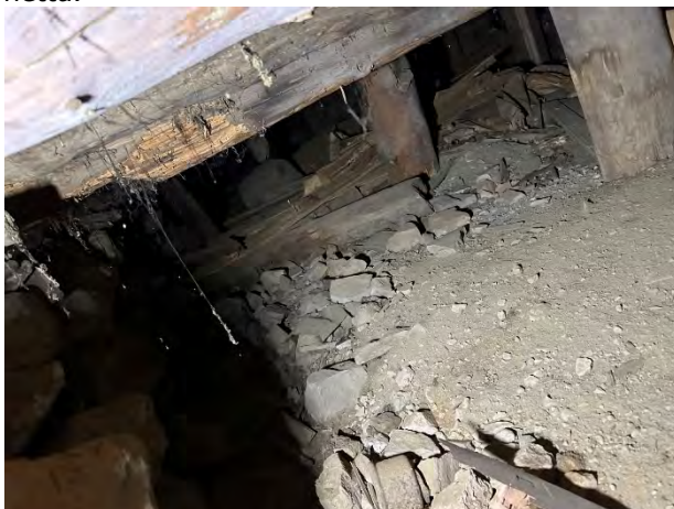
Kuva 70. Alapohjan ryömintätilassa paikoin orgaanista jätettä ja muuta rakennusjätettä.
