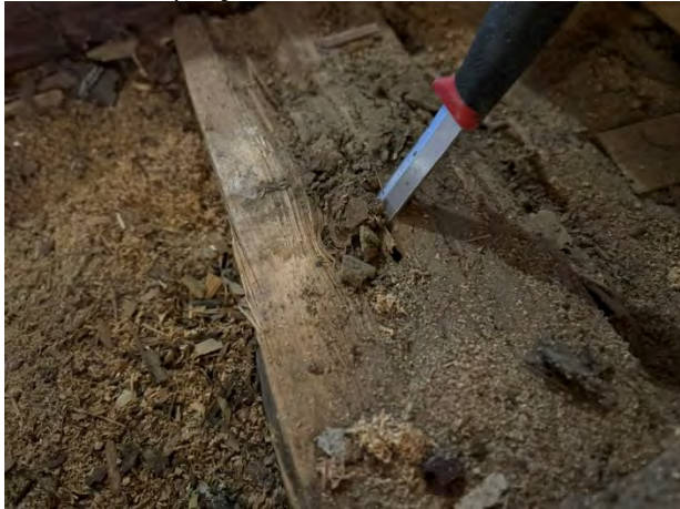
Kuva 32. Alapohjan lahovaurioituneita rakenteita.
