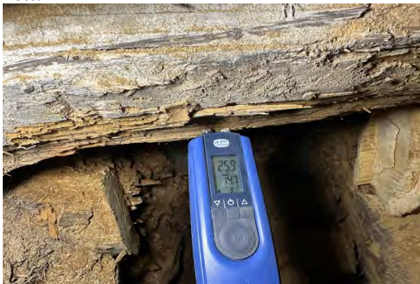
Kuva 62. Ulkoseinän alareuna on märkä, painprosentit 25,9 (raja-arvo on 18,9).
