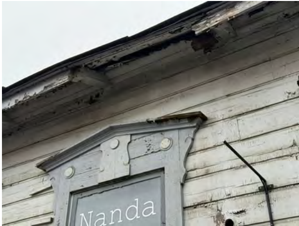
Kuva 44. Rästissä lahovaurioita, osa rästäsrakenteista sortunut.
