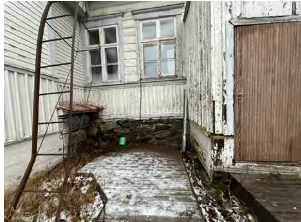
Kuva 35. Sisäpihan julkisivua, runsaasti kosteuden aiheuttamia vaurioita.
