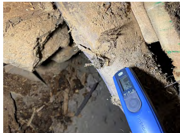
Kuva 71. Alapohjan kantavasta palkista mitattu kohonneita kosteuskokemuksia, kuvassa painoprosentit 18,8 (raja-arvo on 18,0).
