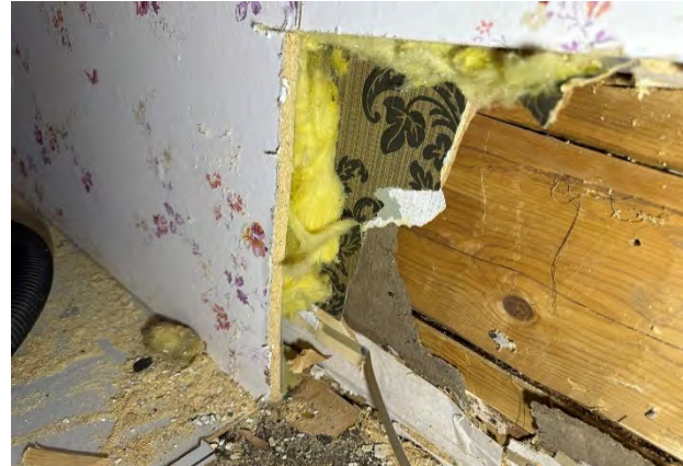
Kuva 19. Sisäpuolelta eristetyllä ulkoseinän osalla havaittiin kosteusvaurioindikaattorimikrobeja.
