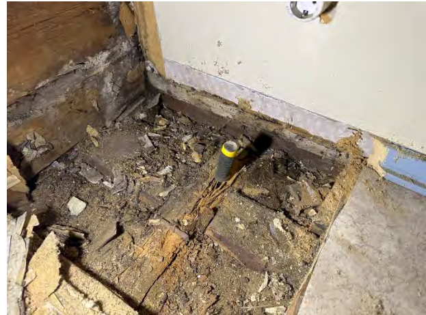
Kuva 75. Alapohjan lahovaurioituneita rakenteita.
