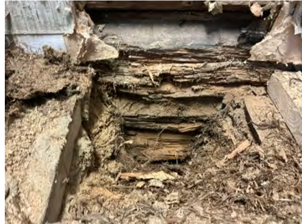
Kuva 25. Ulkoseinän alaosan lahovauriota.
