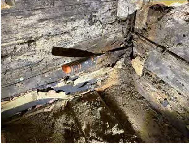
Kuva 66. Ulkoseinän alaosan lahovauriota.
