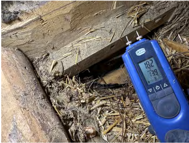
Kuva 72. Alapohjan eristetilan alapinnassa olevan laudoituksen kosteudet koholla, painoprosentit 18,2 (raja-arvo on 18,0).
