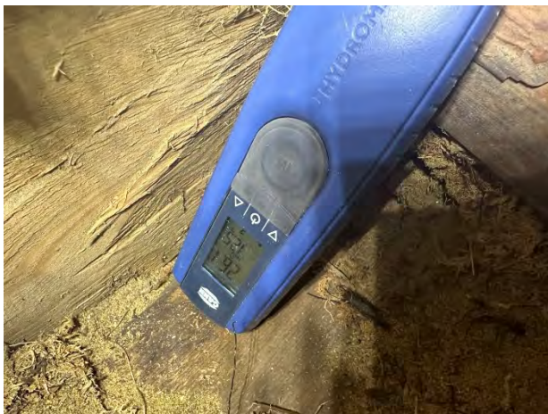
Kuva 76. Alapohjarakenteesta mitattu korkeita kosteuslukemia, kuvan painoprosentit 26,1 (raja-arvo on 18,0).
