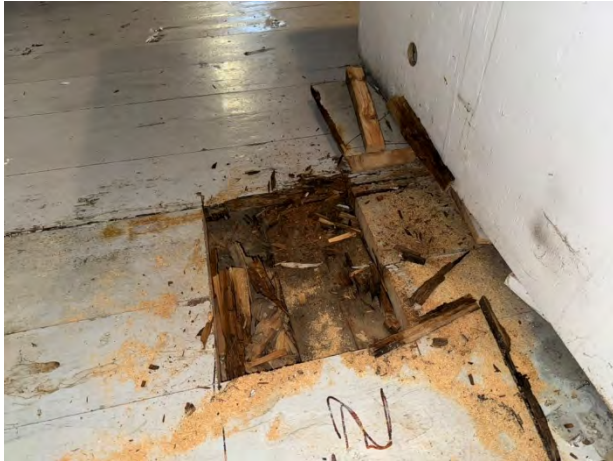
Kuva 30. Alapohjan lahovaurioituneita rakenteita.
