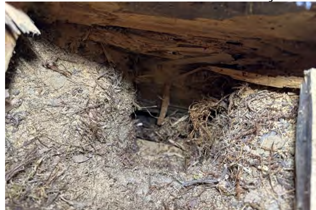
Kuva 21. Lahovauriota ulkoseinän alareunan hirsissä.
