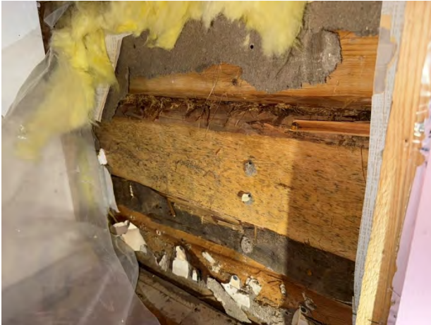
Kuva 24. Ulkoseinän sisäpuolista eristettä, eristeestä otetussa materiaalinäytteessä havaittiin kosteusvaurioindikaattorimikrobeja.
