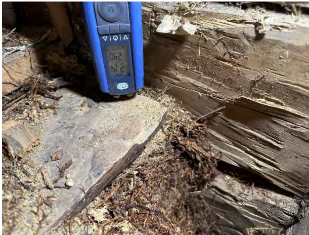
Kuva 26. Alapohjan yläpinnan laudoitus on kostea, painoprosentit 21,4 (raja-arvo on 18,0).
