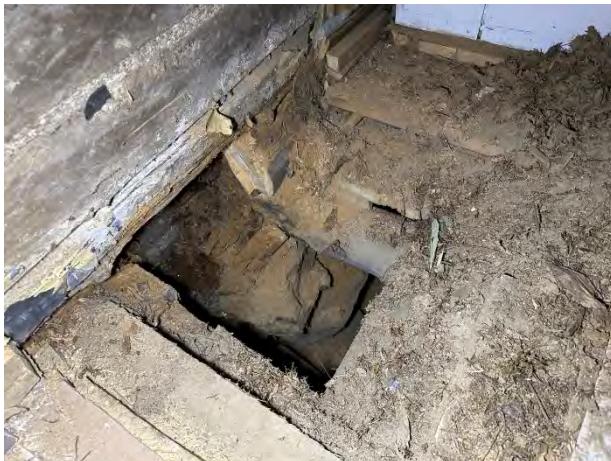
Kuva 68. Alapohjan lahonneita rakenteita, kantavien alapohjapalkkien päissä paikoin lahovaurioita. Savilahdenkadun korko on rakennuksen matalamman pään lattian kanssa samassa korossa, joka vaurioittaa ulkoseinien alaosan ja alapohjan rakennetta.
