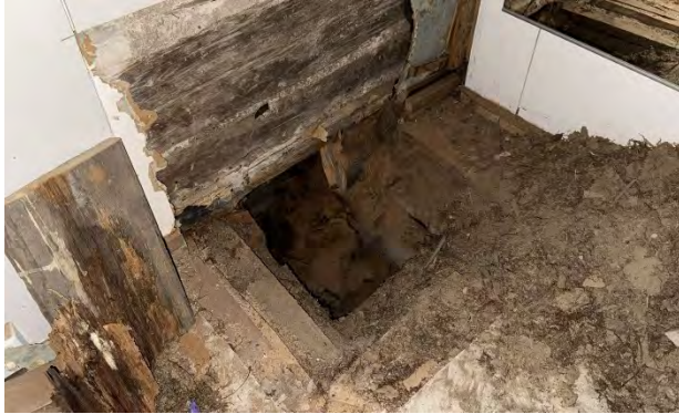
Kuva 60. Ulkoseinän alaosan läpilahonnutta rakennetta.
