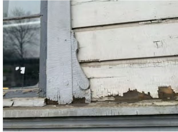
Kuva 41. Julkisivun vaurioita, myös ulkopuolen ikkunapuitteet ovat paikoin huonossa kunnossa.
