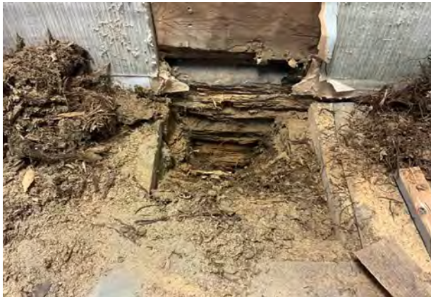
Kuva 22. Lahovauriota ulkoseinän alaosassa.
