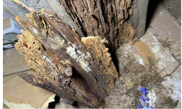
Kuva 61. Ulkoseinän alaosan lahovauriota.
