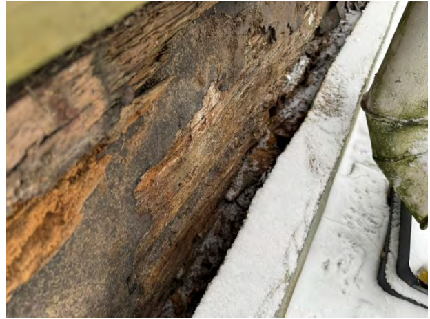
Kuva 67. Ulkopuolen julkisivu on otetun kuvan kohdalla lahonnut pois ja hirsirungon alaosassa on lahovaurioita.
