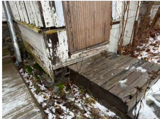
Kuva 37. Sisäpihan julkisivun vaurioita.
