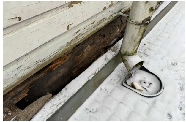
Kuva 81. Julkisivun alareunasta poislahonneita puuosia.
