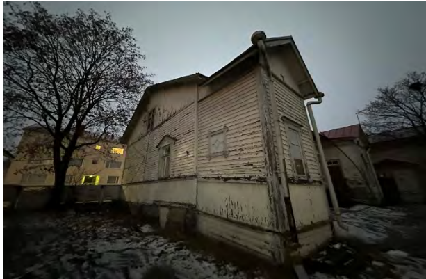
Kuva 78. Rakennuksen päädyn julkisivun vaurioita.
