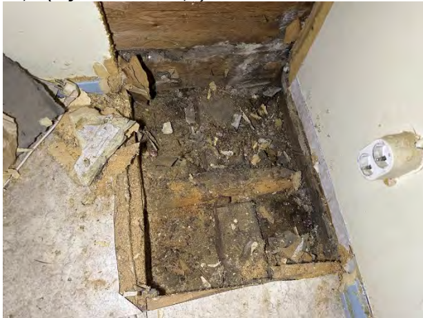
Kuva 74. Alapohjan lahovaurioituneita rakenteita.
