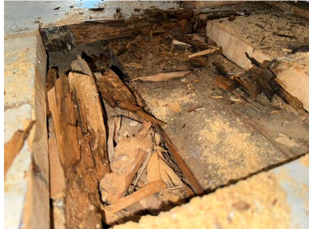
Kuva 33. Alapohjan lahovaurioituneita rakenteita.
