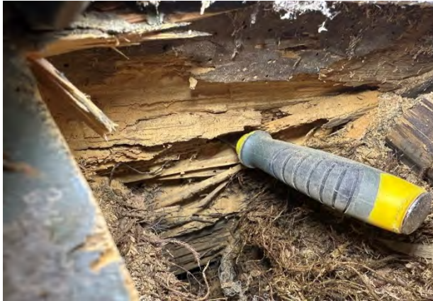
Kuva 18. Ulkoseinän alareunassa monin paikoin lahovaurioituneita hirssiä.
