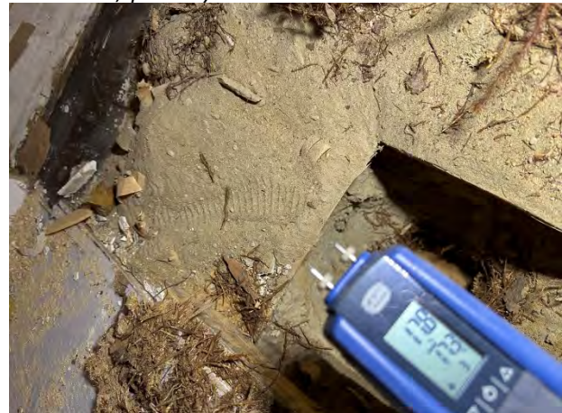
Kuva 29. Alapohjan alapinnan laudoituksen kosteudet ovat hieman koholla, painoprosentit 17,8 (raja-arvo on 18,0).
