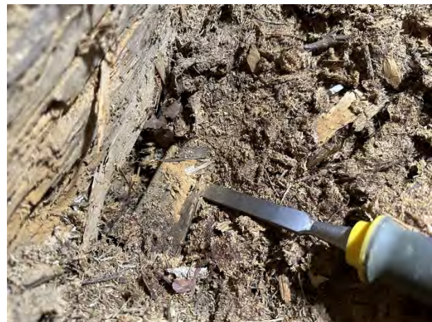
Kuva 77. Alapohjan lahovaurioituneita rakenteita.
