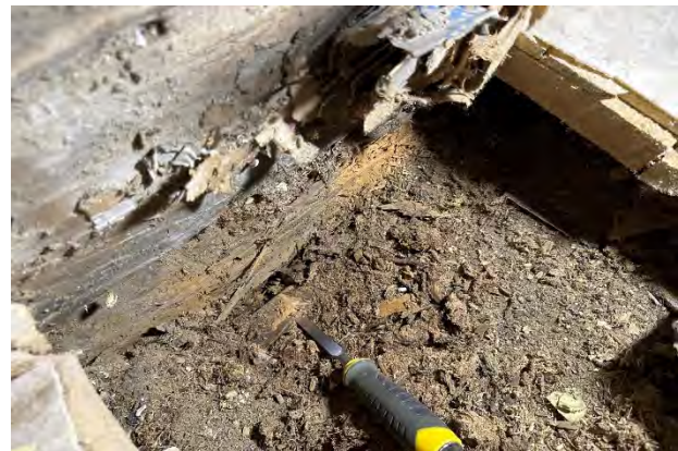
Kuva 63. Ulkoseinän alaosan lahovauriota.
