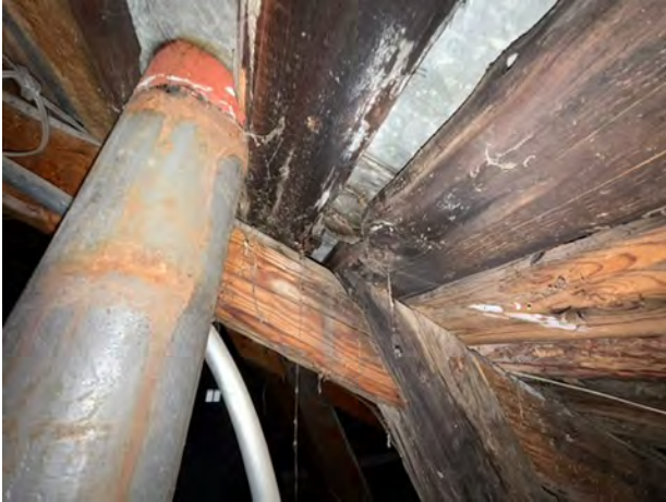
Kuva 86. Vesikaton paikallinen vuotokohta.
