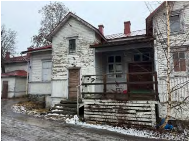
Kuva 34. Sisäpihan puolen julkisivua. Julkisivuja ei ole huollettu ja kosteus on päässyt lahottamaan julkisivuverhousta ja sen osia.
