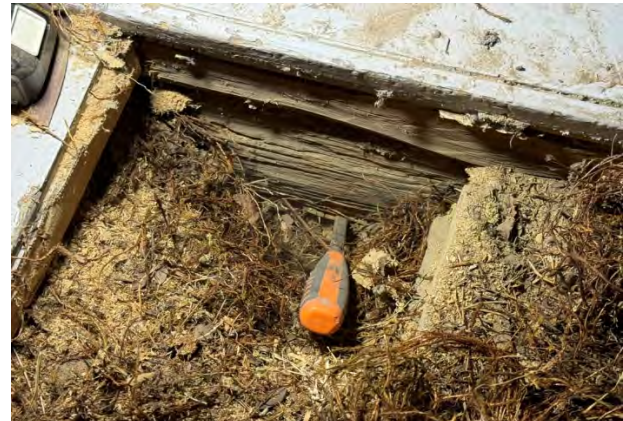
Kuva 23. Lahovauriota ulkoseinän alaosassa.
