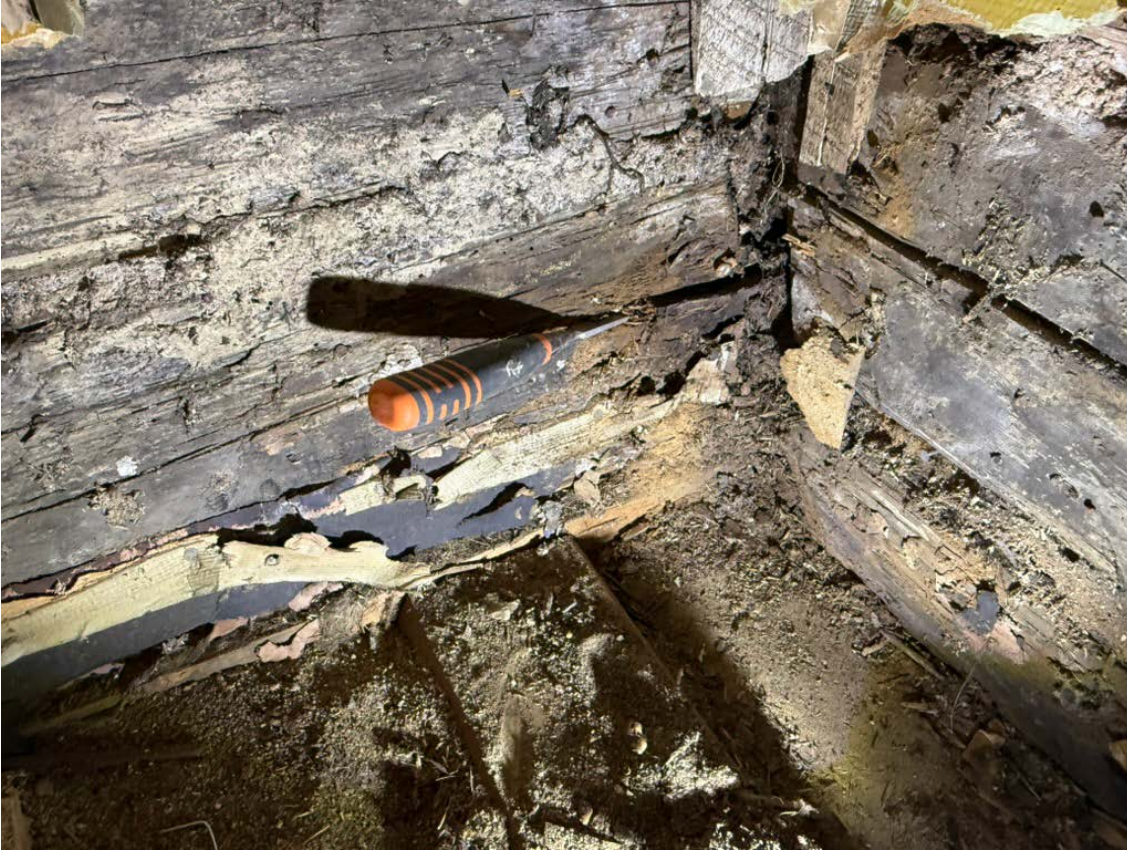
Kuva 27. Rakenne on osin katutason alapuolella ja hirsien alimmat kerrokset ovat lahonneet.
