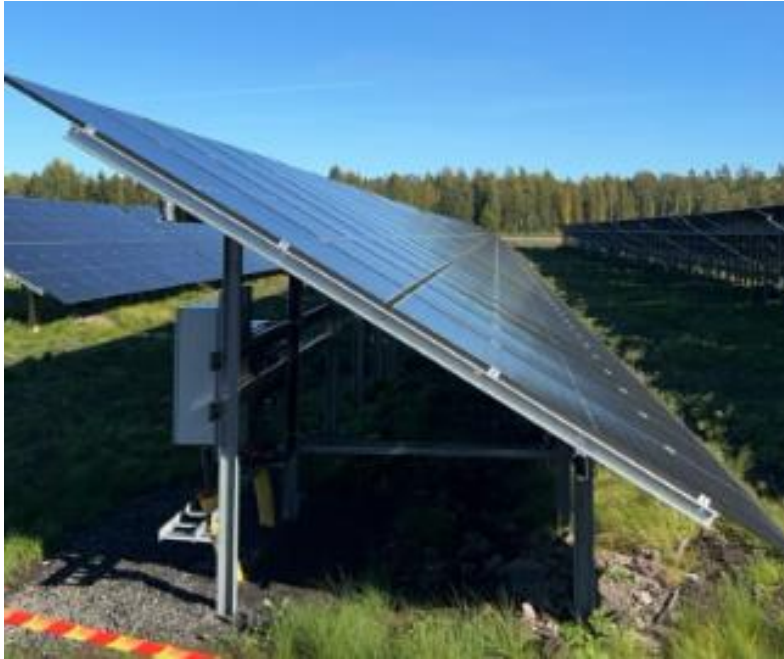
Kuva 8. Omien perustusten varaan asennettuja aurinkopaneeleita (Sitema Oy)
