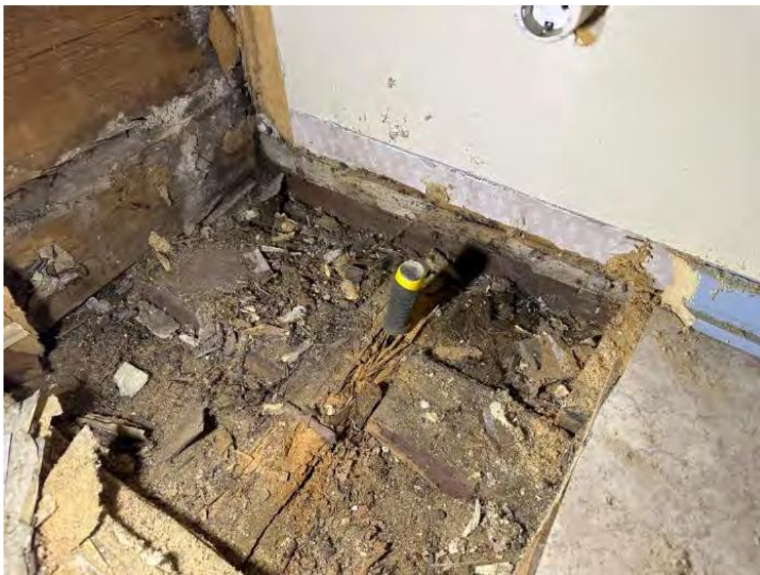
Kuva 4. Kuntotutkimuksessa olevien rakennusten alapohjarakenteissa ja ulkoseinissä on todettu rakenneavausten, materiaalinäytteiden ja kosteusmittausten perusteella olevan kosteus- ja lahovaurioita sekä sisältävän runsaasti kosteusvaurioindikaattorimikrobeja. (Lähde: Kuntotutkimus 2026)
