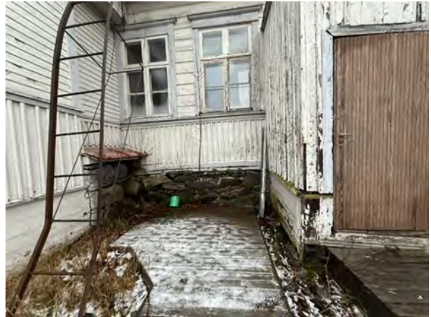
Kuva 35. Sisäpihan julkisivua, runsaasti kosteuden aiheuttamia vaurioita.
