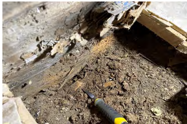
Kuva 63. Ulkoseinän alaosan lahovauriota.
