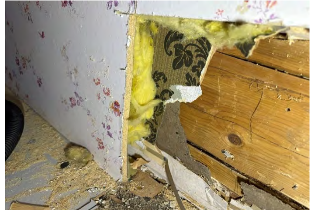
Kuva 19. Sisäpuolelta eristetyllä ulkoseinän osalla havaittiin kosteusvaurioindikaattorimikrobeja.
