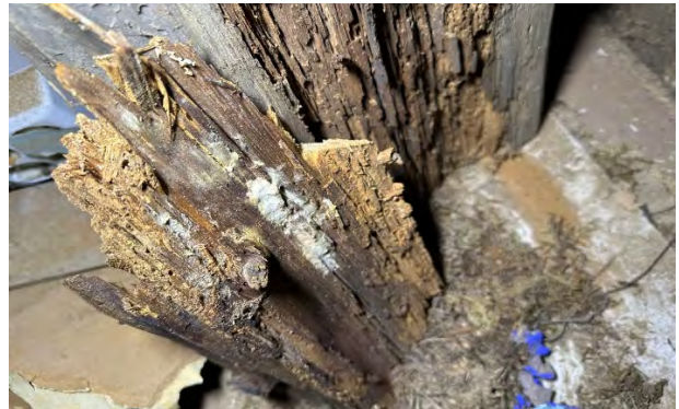
Kuva 61. Ulkoseinän alaosan lahovauriota.
