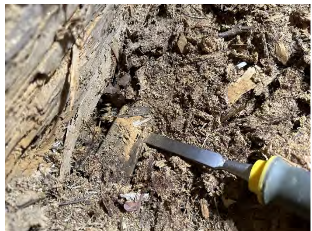
Kuva 77. Alapohjan lahovaurioituneita rakenteita.
