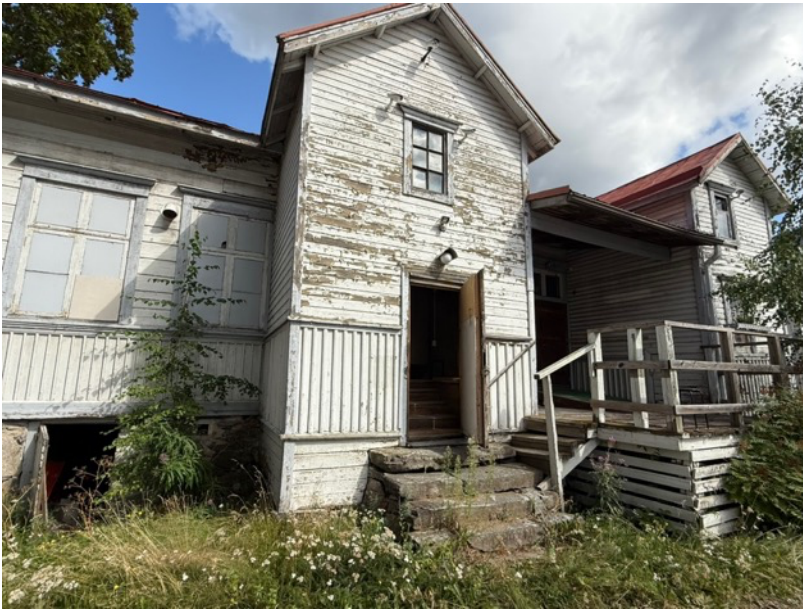
Kuva 1. Ulkoverhous on pahoin rapistunut.
