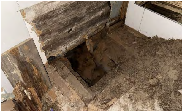
Kuva 60. Ulkoseinän alaosan läpilahonnuttua rakennetta.
