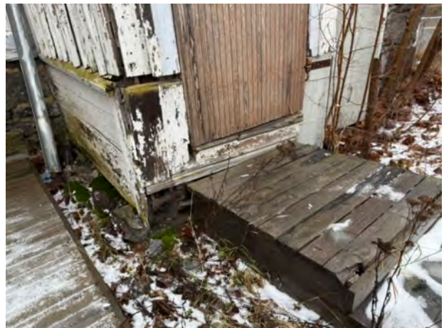
Kuva 37. Sisäpihan julkisivun vaurioita.
