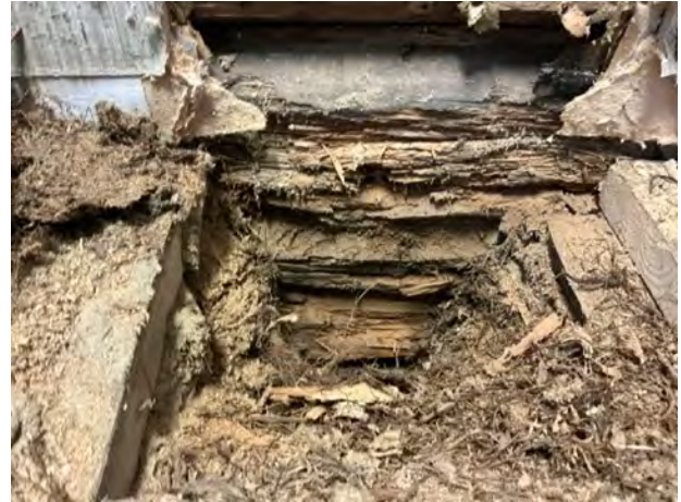
Kuva 25. Ulkoseinän alaosan lahovauriota.
