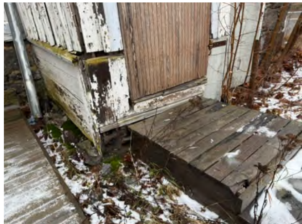
Kuva 37. Sisäpihan julkisivun vaurioita.
