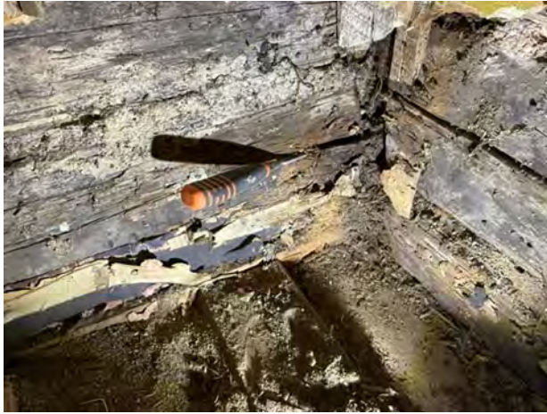
Kuva 66. Ulkoseinän alaosan lahovauriota.
