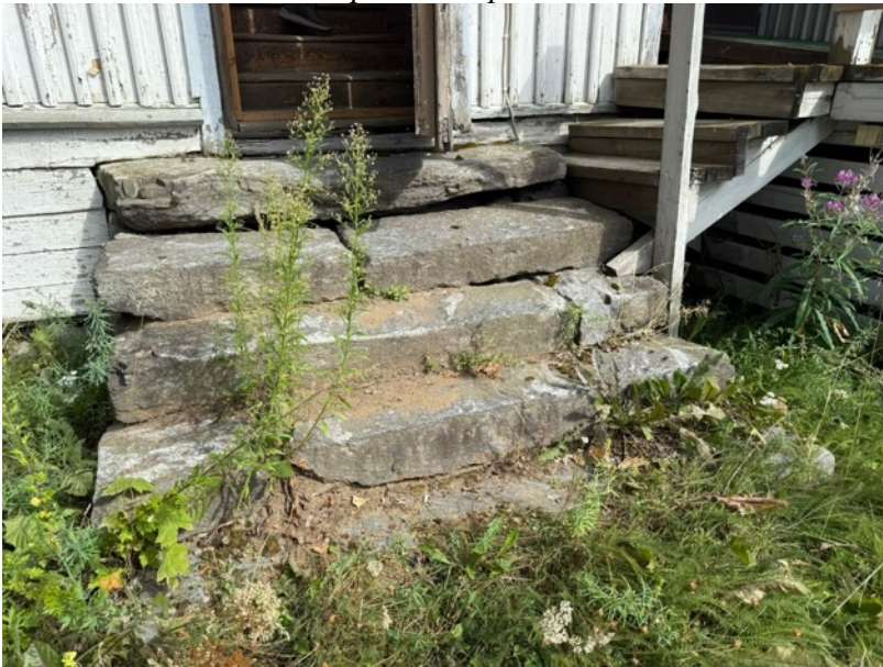
Kuva 2. Talon perustukset ovat painuneet.
