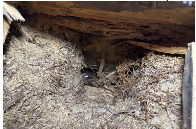
Kuva 21. Lahovauriota ulkoseinän alareunan hirsissä.
