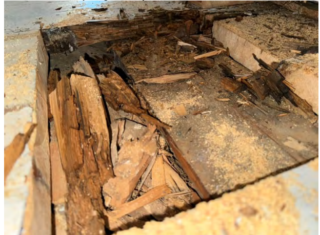
Kuva 33. Alapohjan lahovaurioituneita rakenteita.
