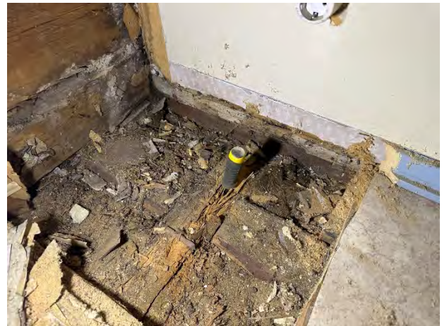
Kuva 75. Alapohjan lahovaurioituneita rakenteita.
