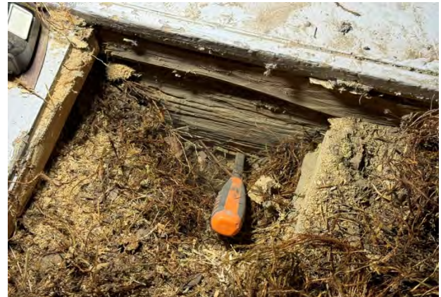
Kuva 23. Lahovauriota ulkoseinän alaosassa.
