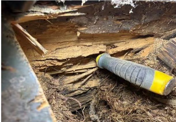
Kuva 18. Ulkoseinän alareunassa monin paikoin lahovaurioituneita hirssiä.
