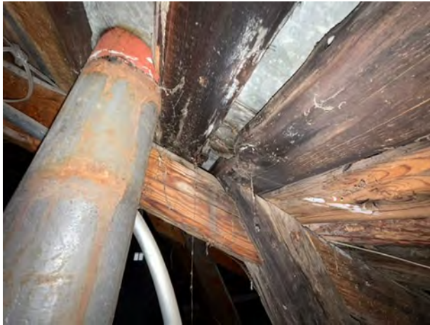
Kuva 86. Vesikaton paikallinen vuotokohta.
