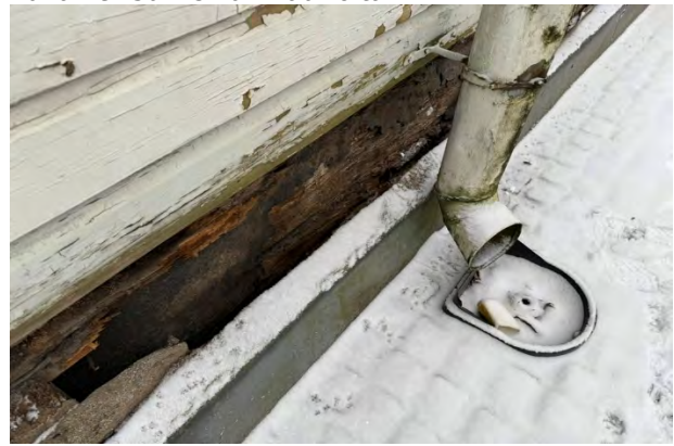
Kuva 81. Julkisivun alareunasta poislahonneita puuosia.
