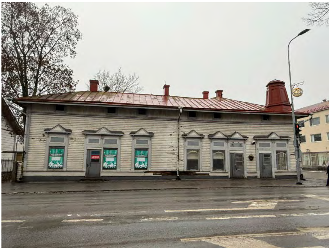
Kuva 18. Savilahdenkatu kulmatalon julkisivu joulukuussa 2025.
